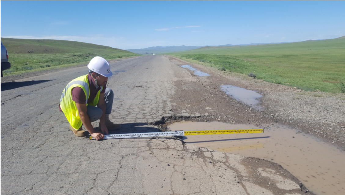
Зураг-6. Км356+240 Асфальтобетонд ирмэгийн эвдрэл, нүх, торон хагарал үүссэн байдал
