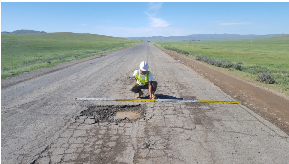
Зураг-5. Км389+860 Асфальтобетонд торон хагарал, нүх, дугуй мөрний ховил үүссэн байгаа нь
