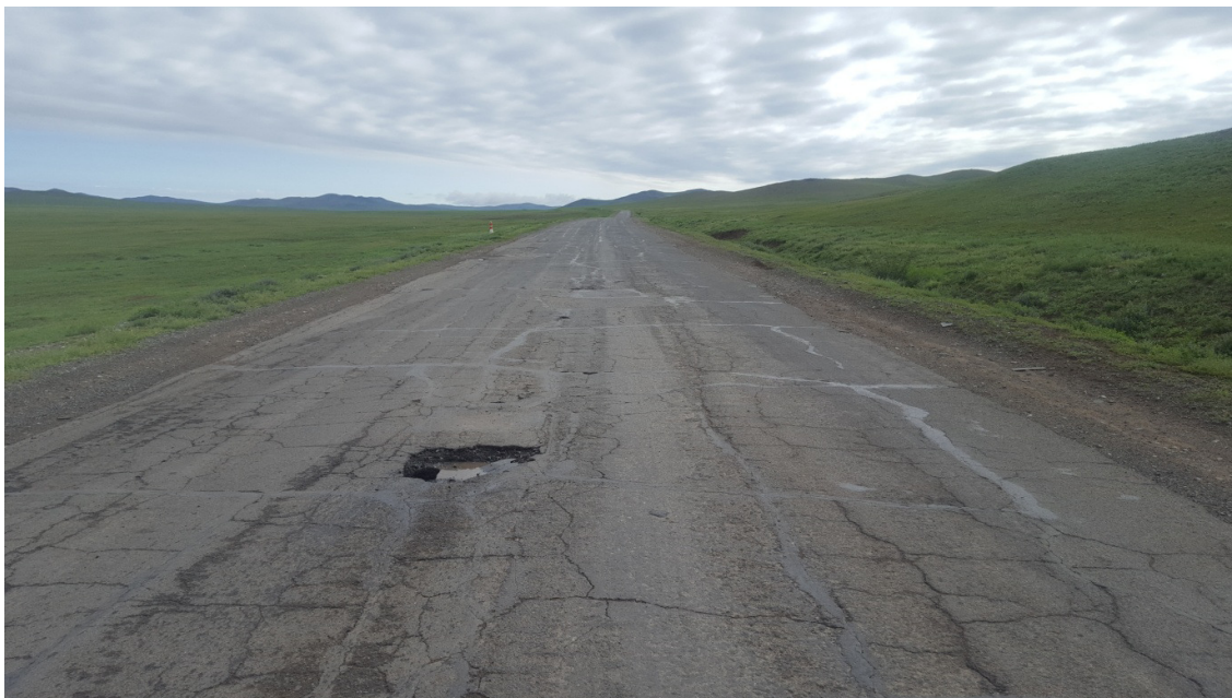
Зураг-8. Км391+440 Их эвдрэлтэй хучилтын ерөнхий байдал -1
