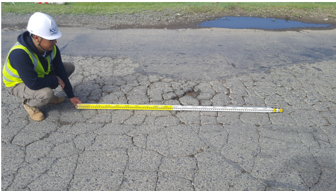
Зураг-3. Км362+540 Асфальтобетон хучилтанд үүссэн торон хагарал.
