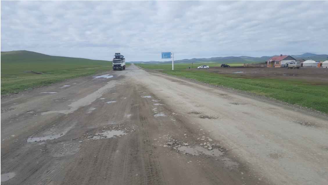
Зураг-10. Км354+480 Асфальтобетон хучилтгүй болсон хэсэг
