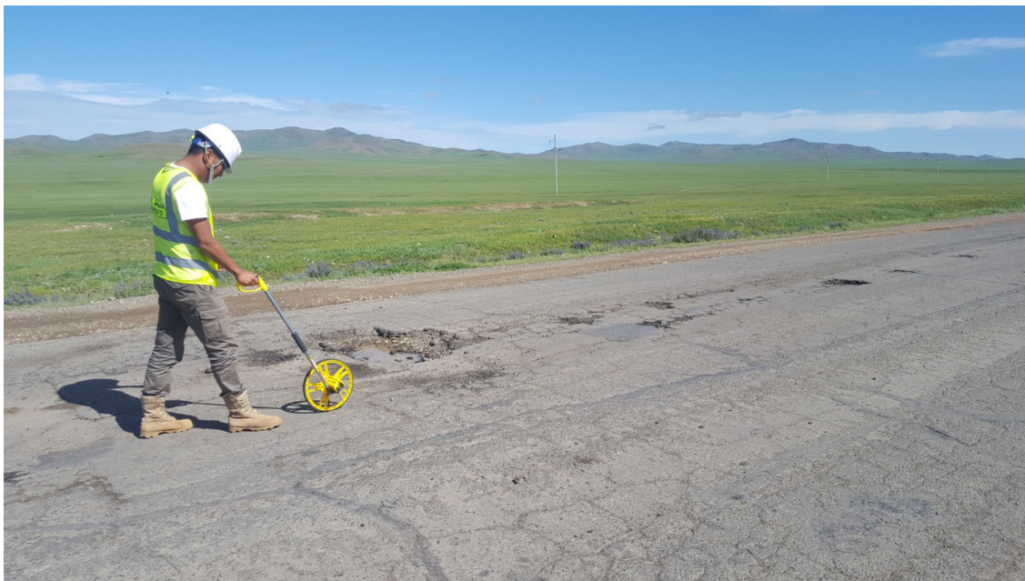
Зураг-4. Км357+320 Асфальтобетоны эвдрэлийн байдал
