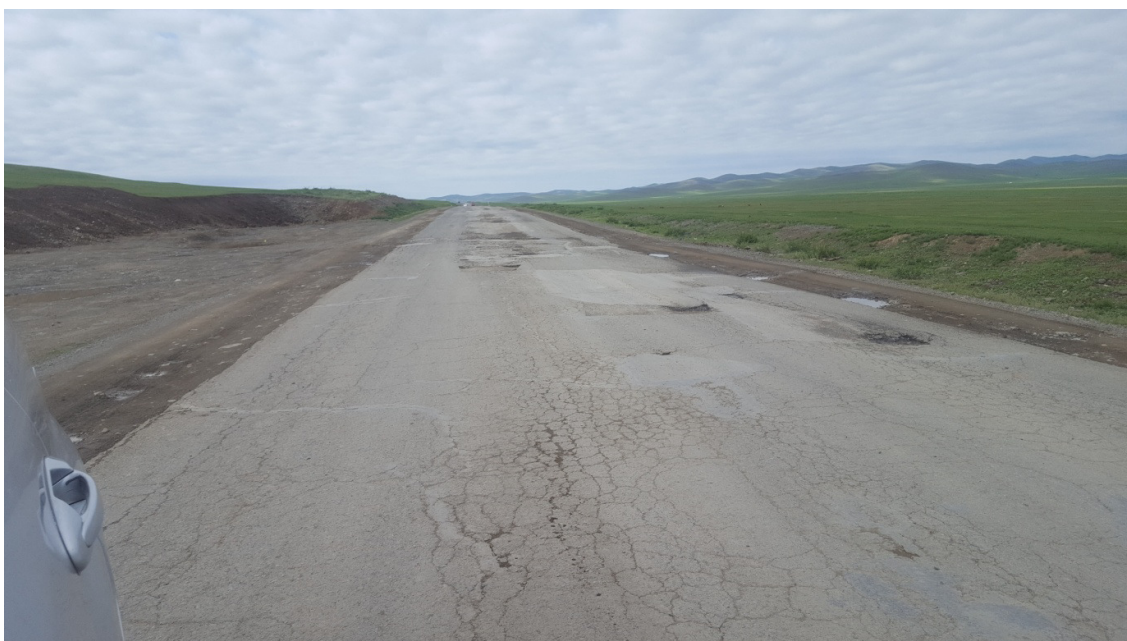
Зураг-9. Км355+100 Их эвдрэлтэй хучилтын ерөнхий байдал -2
